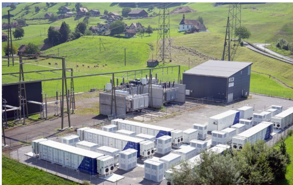
La batterie située en Suisse centrale a une puissance de 20 MW.
