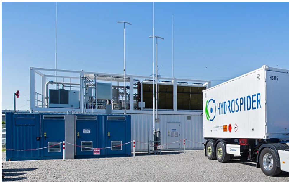
L'installation d'électrolyse produit de l'hydrogène en utilisant l'électricité de la centrale hydroélectrique de Gösgen. Photo: Jean-Luc Grossmann
